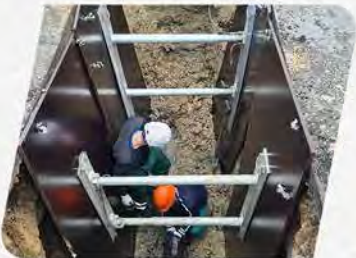
Lekkie hydrauliczne rozpory pionowe
