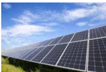
Instalacje wytwarzania OZE w różnych obiektach
